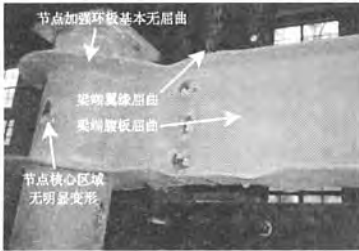
(b)圆柱框架梁端典型破坏形态
